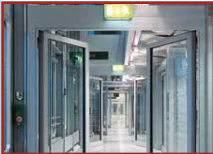
Einbindung automatischer Schleusen
